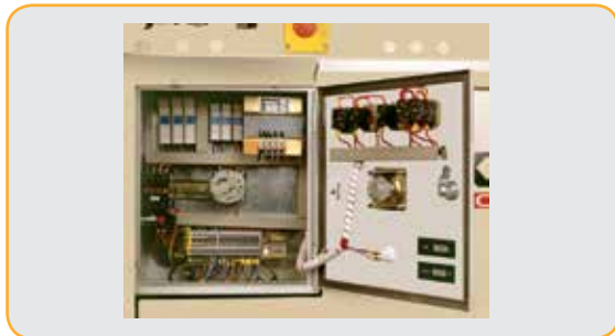
Cuadro eléctrico con elementos de protección y mando integrados
